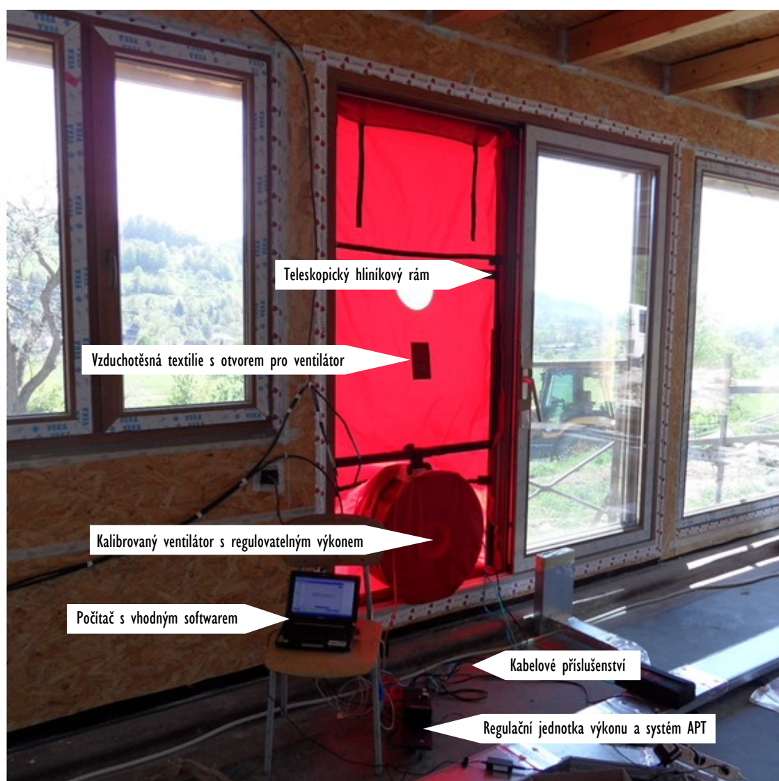
Obr. č. 6: Osazení aparatury a měření průvzdušnosti metodou tlakového spádu - Blower Door Test
